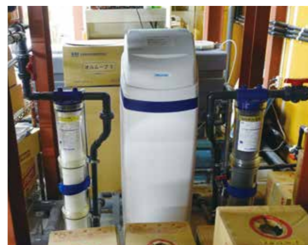
▲「原水処理機構」の濾過装置
