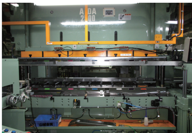
【図1】今回導入した設備
