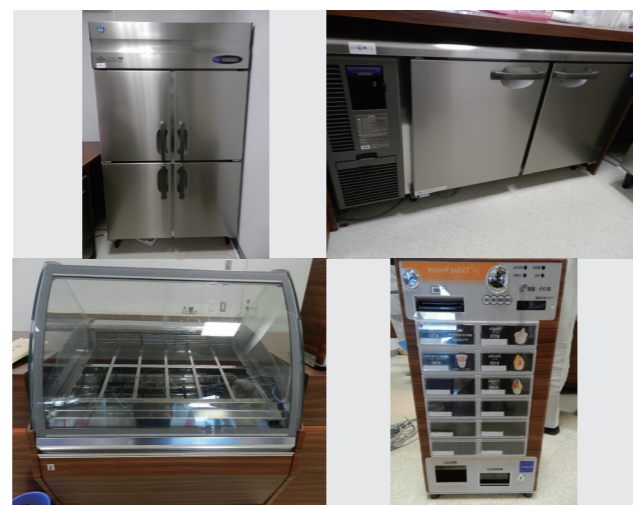
【図1】冷凍庫の設置状態(左上) / テーブル型冷蔵庫の設置状態(右上) / ジェラートショーケースの設置状態(左下) / 券売機の設置状態(右下)
