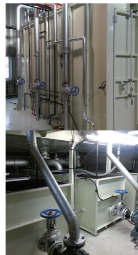
【図2】前処理設備
