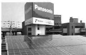
▲ハマダヤ屋上の太陽光システム
